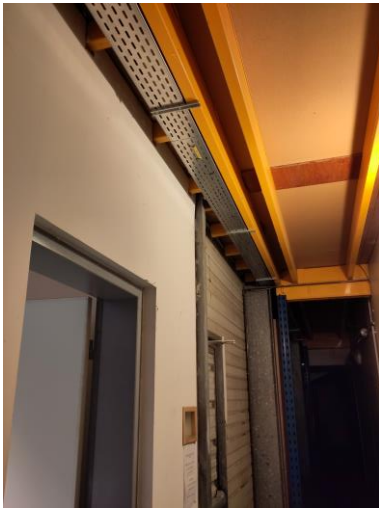
Pénétration dans les ateliers municipaux – Cheminement sur chemin de câbles
